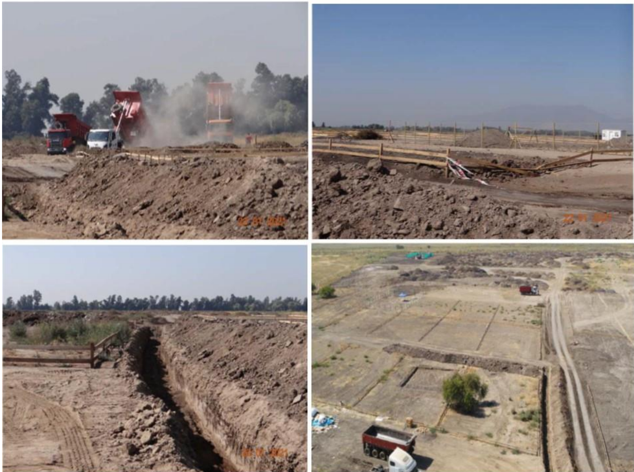
Figura N° 8. Faenas, movimiento de tierra con maquinaria pesada, delimitación de lotes y zanja de drenaje
